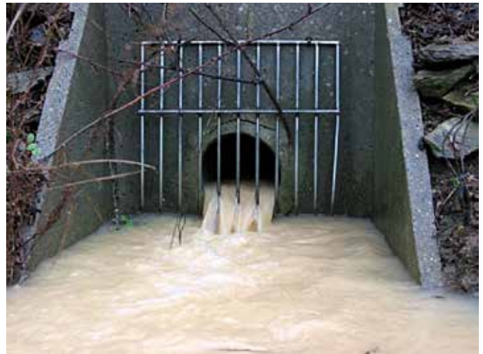
Abbildung 9: Drainageausgänge in Entwässerungsgräben
